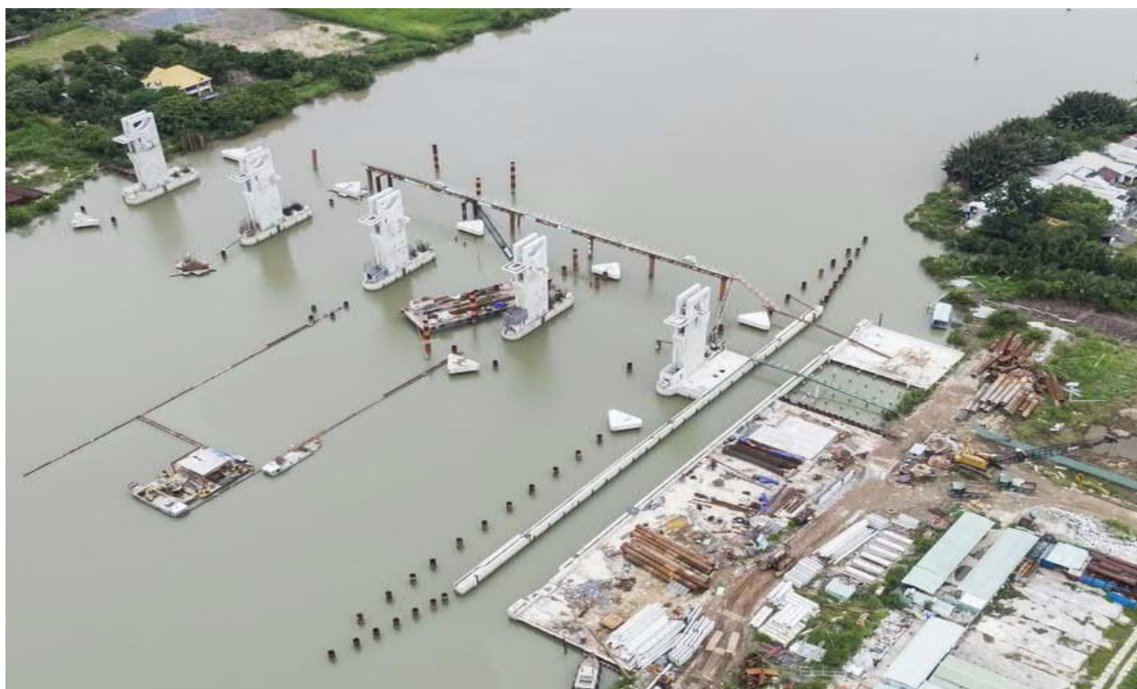
Cổng Mương Chuối có quy mô lớn nhất trong 6 cổng. Cổng có chiều dài hơn 200m được thiết kế với 4 cửa van nặng khoảng 200 tấn. Cổng được xây dựng trên sông Mương Chuối (huyện Nhà Bè) để ngăn triều dâng từ sông Nhà Bè
