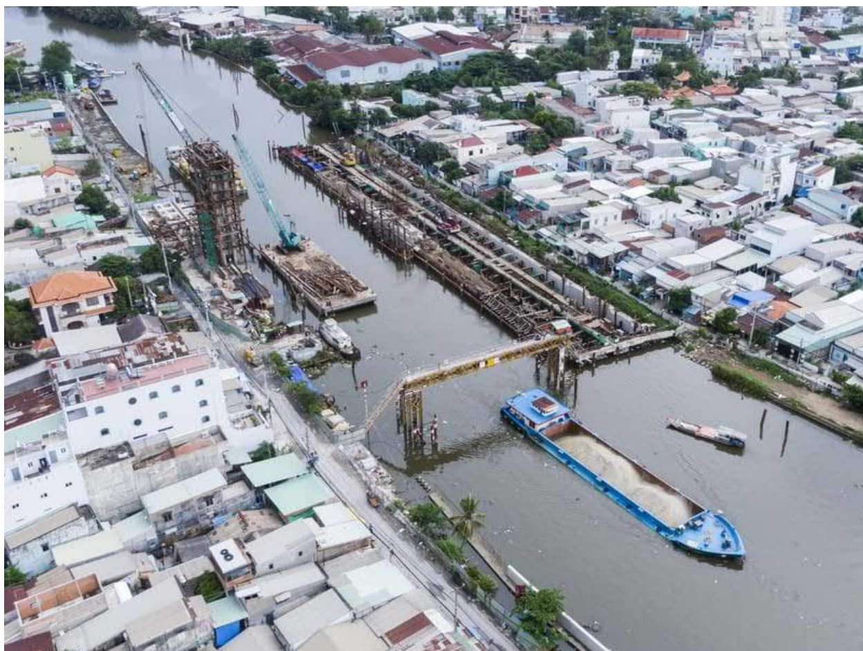
Cổng Phú Định trên Kênh Đôi, nằm giữa 2 ngã ba sông Cần Giuộc – Chợ Đệm – Kênh Đôi và Kênh Đôi – Kênh Tàu Hũ. Cổng này thuộc địa phận quận 8, ngăn triều từ sông Vàm Cỏ Đông và sông Cần Giuộc đổ vào trung tâm thành phố.
