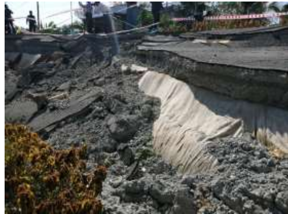
Hình 2: Sụt lún đoạn đường nổi ra đê biển
