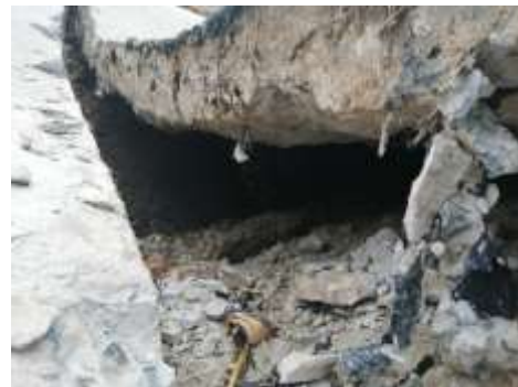
Hình 4: Đất đắp đê tụt xuống, tách khỏi mặt đường
