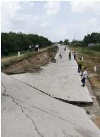
Hình 1: Sụt lún đoạn đê trực tiếp với biển
