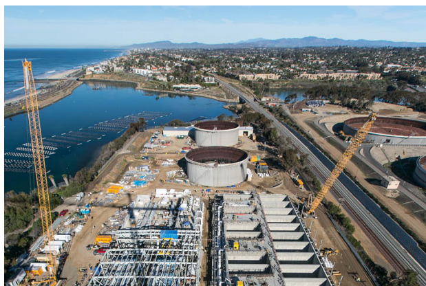
Nhà máy khử muối Carlsbad, California. [Ảnh: Butier Engineering]
