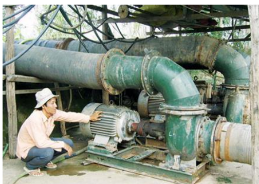
Trạm bơm ở ĐBSCL
