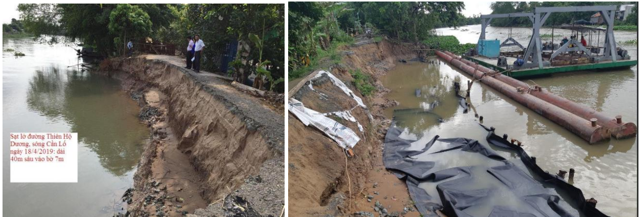
Hình 17. Điểm sạt lở đứt đoạn đường Thiên Hộ Vương, Cao Lãnh, Đồng Tháp, 2019
