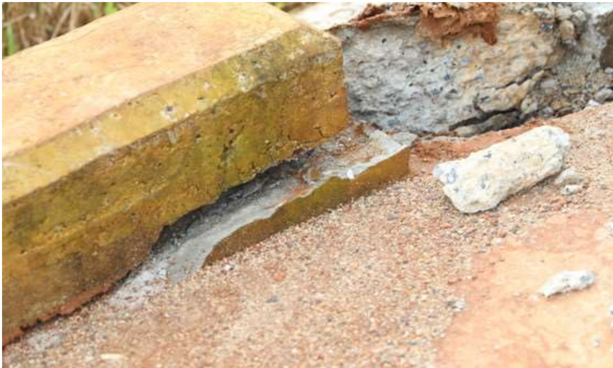
Nhiều vết nứt trên mặt đỉnh đập
