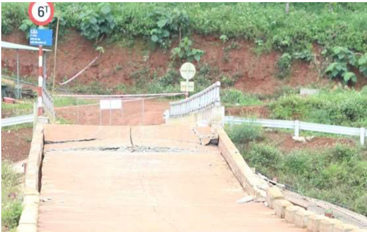
Nhiều điểm nứt trên mặt đỉnh đập
