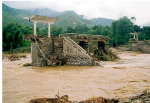
Công trình Thủy lợi xã Sơn Thịnh, huyện Văn Chấn bị phá huỷ trong trận lũ quét 28-9-2005
