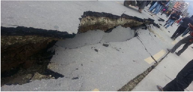
Nứt mặt đường ở thủ đô Kathmandu do động đất
