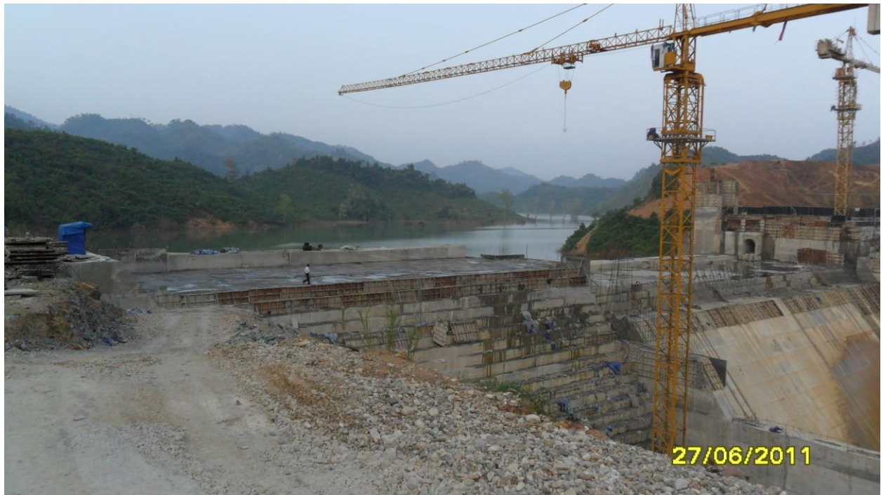
Nước được tích trên thượng lưu đập để điều tiết cho hạ du
