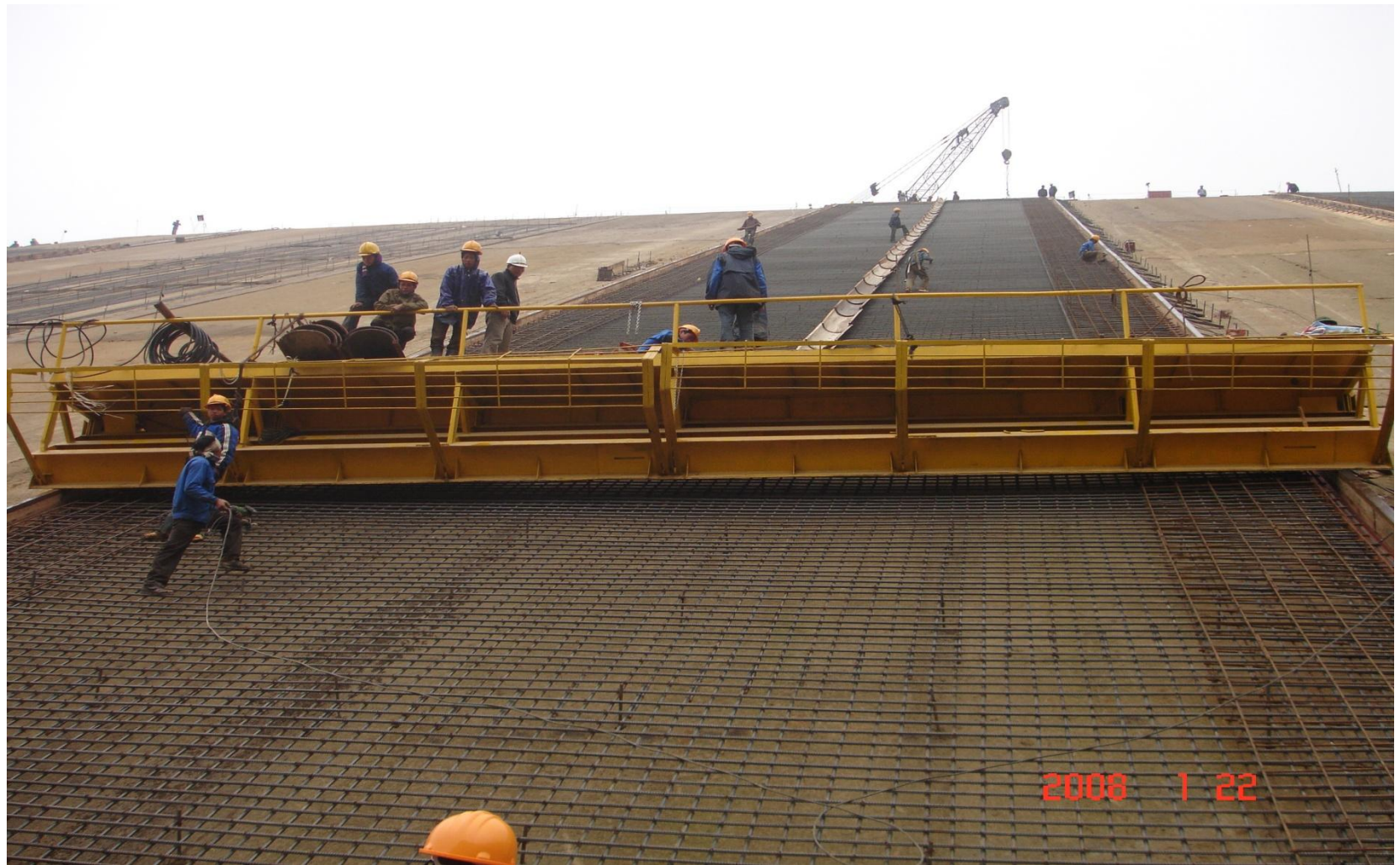
Cốt pha trượt thi công bê tông bản mặt đập chính Cửa Đập
