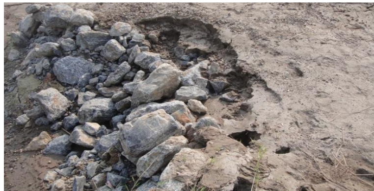
Hình 11. Kè đá cũ bị phá hỏng
