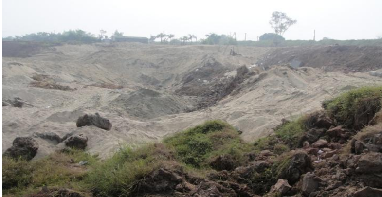
Hình 6. Khu vực sạt trượt kè Hữu Hồng nhìn theo tuyến đê hữu Hồng về phía hạ lưu.
