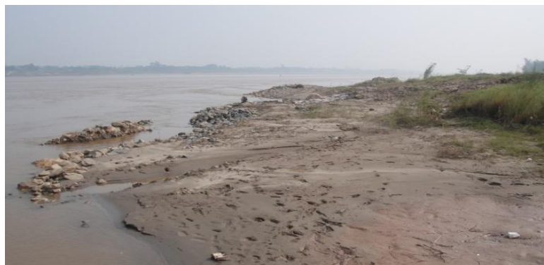
Hình 12. Kè đá cũ bị đẩy dịch về phía sông
