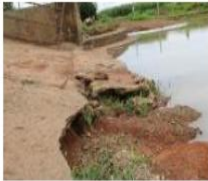
Sập tường cánh tràn xả lũ, đập Yang Kang, tỉnh Đắk Lắk
