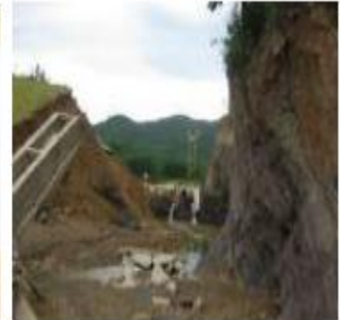
Vỡ đập Z20, tỉnh Hà Tĩnh
