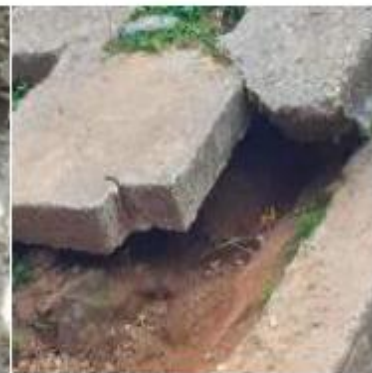
Hang rỗng gây sụt lún bề mặt gia cố đê hữu sông Hồng, TP Hà Nội
