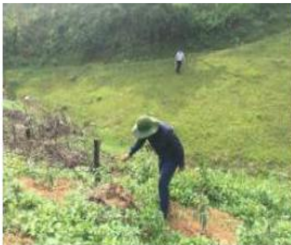
Hình ảnh tổ mối ở trên mái đập
