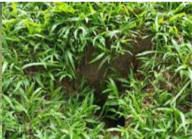
Hồ sục tổ mối trên mái đập
