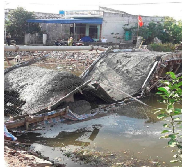
Cầu ở Giao thủy vừa đổ BT xong đã sập 4/12/2018 (cách 4 hôm)
