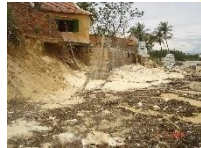
Sạt lở KV xã Tam Hải, Núi Thành
