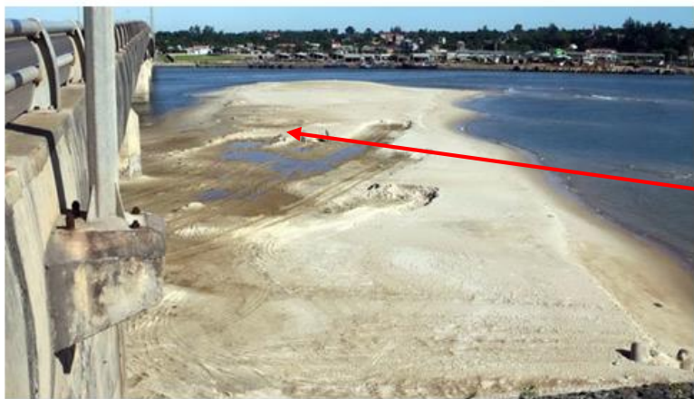
Bồi lấp 2/3 sông đoạn dưới cầu cửa Tùng
