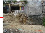
Sạt lở KV thôn An Chuẩn, Kỳ Tân, Đức Lợi
