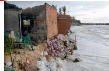
Sạt lở KV xã Tiến Thành-TP Phan Thiết
