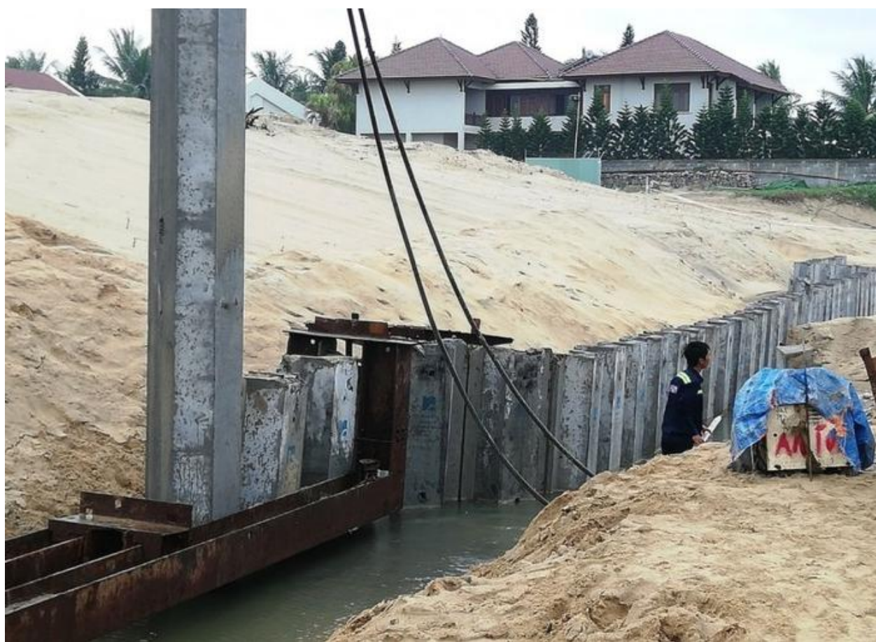
Một số chủ khách sạn ven biển phía Bắc Cửa Đại đã phải bỏ ra số tiền lớn tự làm kè bê tông chắn sóng chống sạt lở
