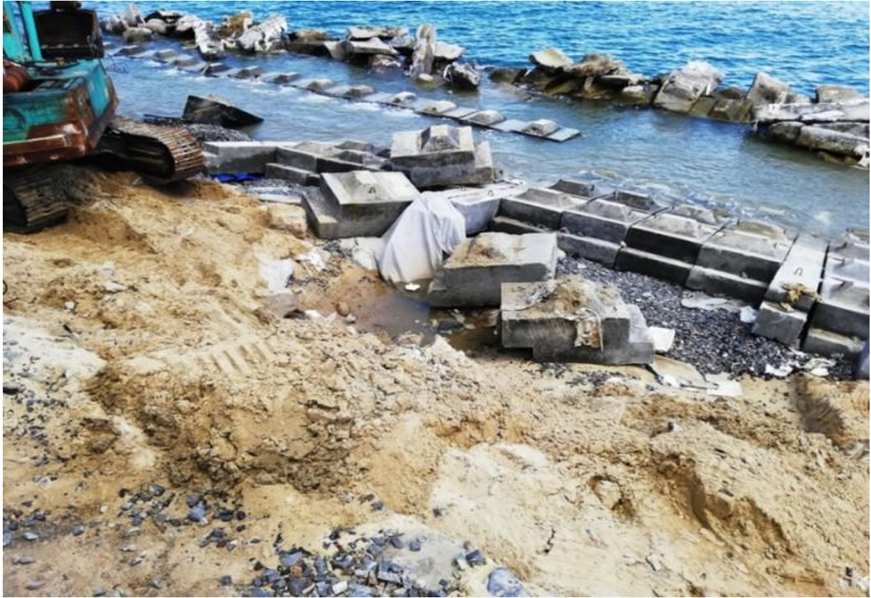
Bờ kè cứng bằng bê tông cũng bị sóng biển đánh gây hư hỏng nghiêm trọng ở nhiều vị trí
