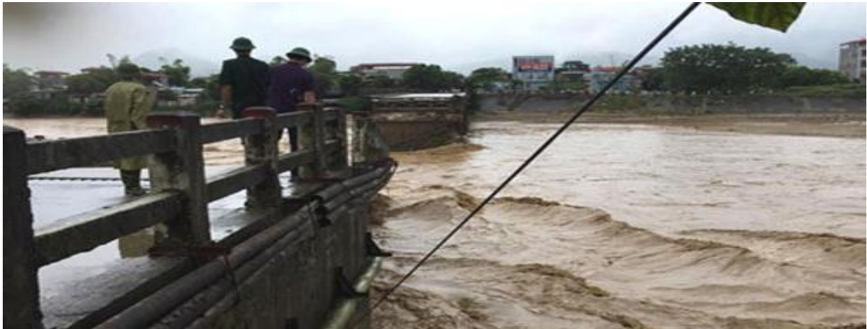
Cầu Ngòi Thia bị sập hai nhịp. Ảnh: Báo Yên Bái
