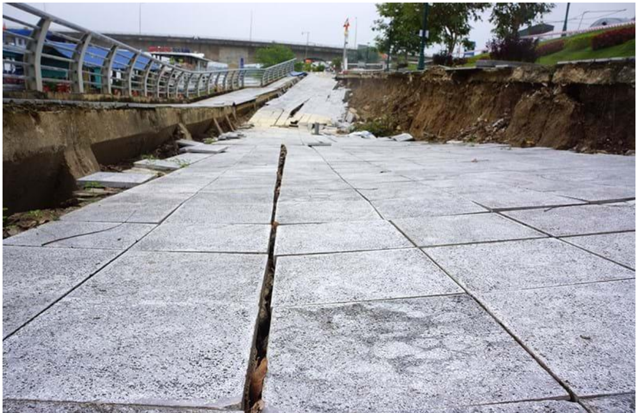
Rất nhiều dấu hỏi về chất lượng công trình đê hữu sông Mã đoạn từ cầu Hàm Rồng đi ngã ba Trần Hưng Đạo (TP Thanh Hóa)
