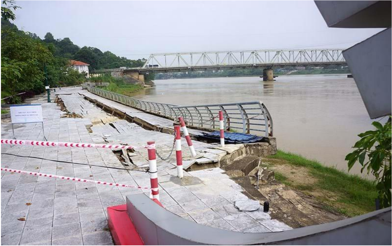
Đoạn bị sụt lún nghiêm trọng có chiều dài khoảng hơn 100m, toàn bộ bề mặt đã bị nứt, toác đến mức buộc phải căng dây thông báo nguy hiểm.
