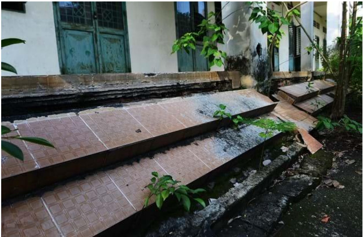
Công trình ở quận 6 bị sụt lún. Ảnh: Lê Quân
