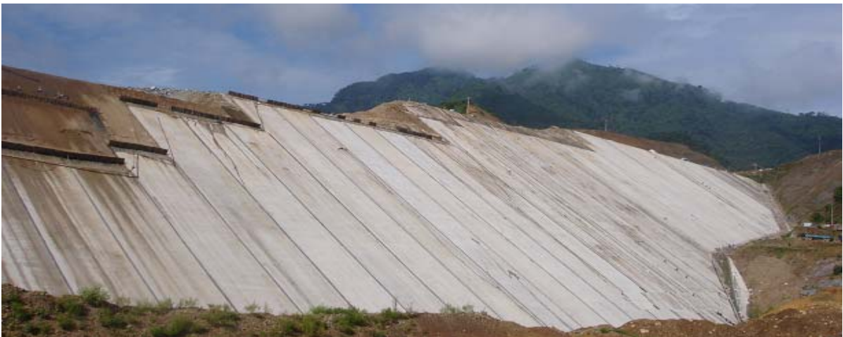
Đập đá nện phủ mặt bê tông cốt thép Cửa Đạt (Thanh Hóa) cao 128m trên sông Chu được xây dựng trong những năm 2004-2009
