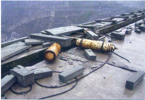
Vết nứt trên đỉnh đập Tử Bình Bạc (Zipingpu)
