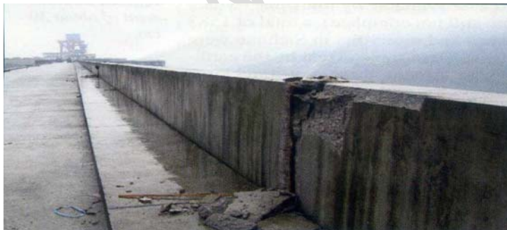
Vết gãy trên tường chắn tại đập Tử Bình Bạc (Zipingpu)
