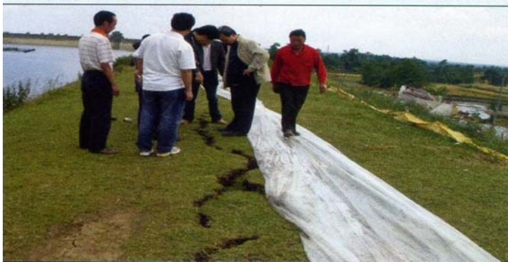
Một tổ chuyên gia Trung Quốc đang thanh sát chỗ lún và đá đổ bị lỏng ra ở mái hạ lưu một trong số đập phụ
