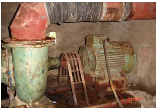
Máy bơm hư hỏng nhưng không có tiền để sửa chữa
