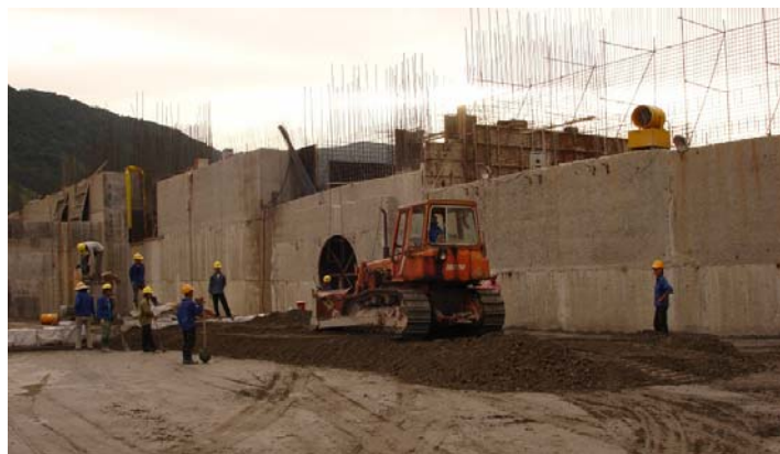
Thi công bởng m l n t i công tr ong p nh Bình
