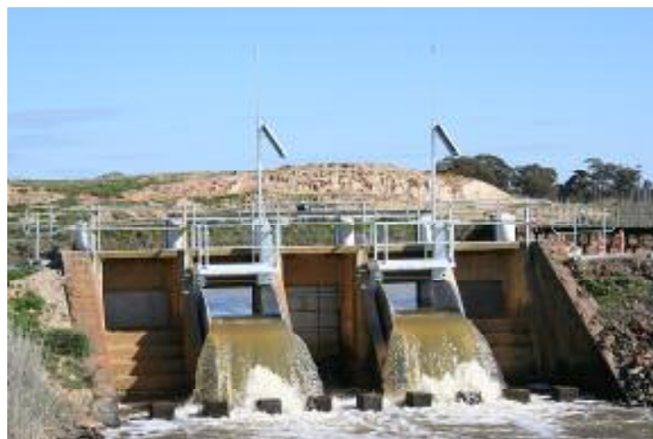
Hình 5: Một dạng công trình điều tiết tự động flumegate của RUBICON
